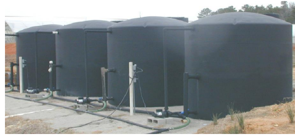
Foto 1. Biofiltre de nitrificare în ferma de suine (73)
